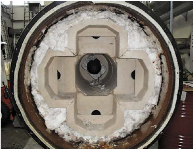
Abb. 1: Blick in die Brennkammer auf den frontseitig montierten Gasbrenner
